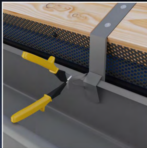
Se crestează jgheabul cu o foarfeca speciala in stânga - dreapta plăcuței de fixare pentru împiedicarea deplasării jgheabului.
